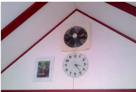
Zeit war's, Abzugsventilator für die Heißluft im Sommer, Peter sei Dank.
